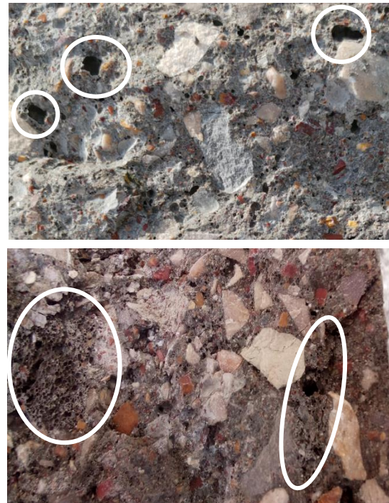
شکل ۷- وضعیت و نحوه وقوع ترک و توزیع حفرات در بتن ۱۰۰٪ بازیافتی
