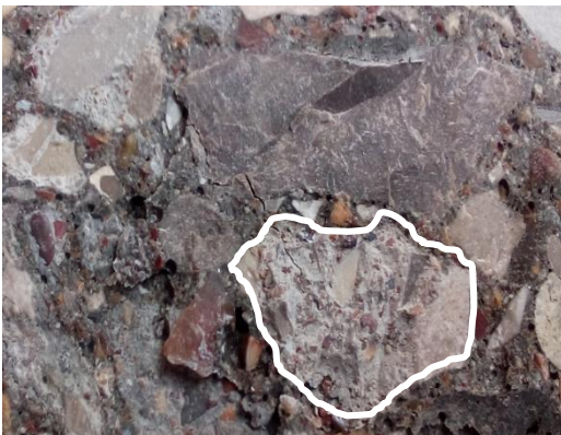
شکل ۶- وضعیت و نحوه وقوع ترک و توزیع حفرات در بتن ۵۰٪ بازیافتی
