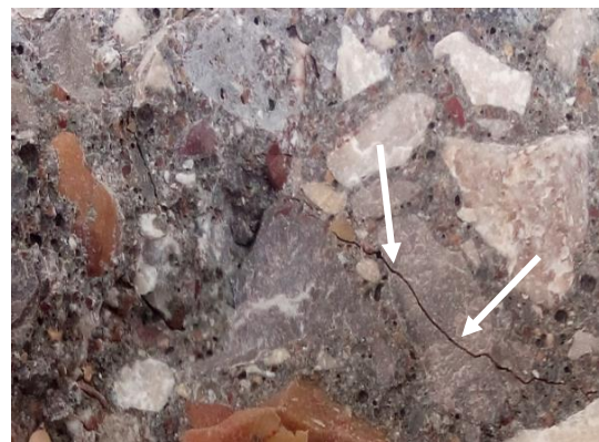
شکل ۵- وضعیت و نحوه وقوع ترک و توزیع حفرات در بتن ۲۵٪ بازیافتی
