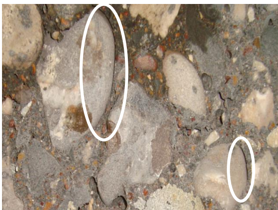
شکل ۴- وضعیت و نحوه وقوع ترک و توزیع حفرات در بتن معمولی
