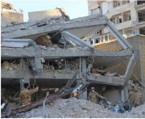
شکل ۱- تخریب ساختمان در اثر گسیختگی اتصالات تحت زلزله ۱۳۹۶ سرپل ذهاب استان کرمانشاه
