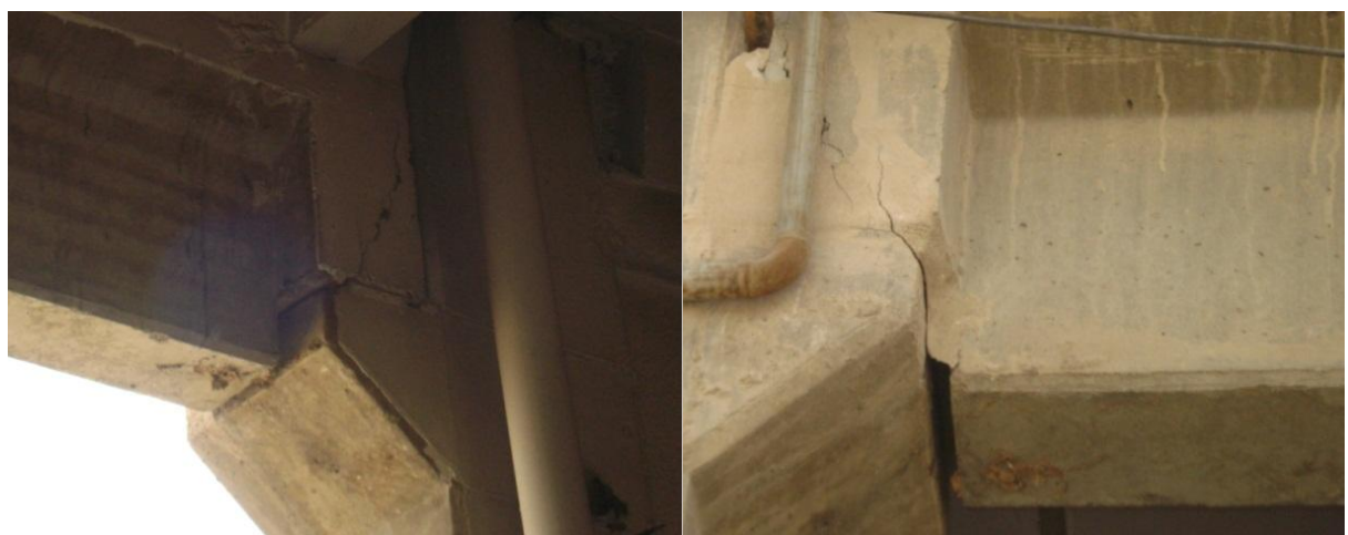
شکل ۲- ترک خوردگی ناشی از تلاش‌های وارده در ناحیه اتصال
