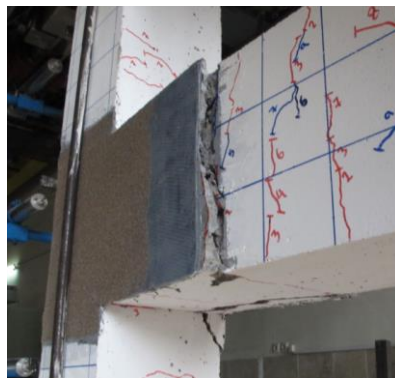
ب) جدا شدن FRP از سطح تیر
