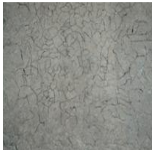
شکل ۹- ترک‌های ایجاد شده در اثر اعمال حرارت
