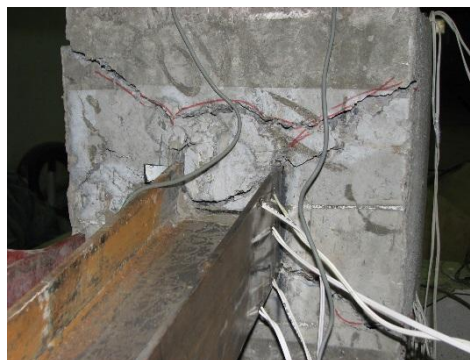
ج: نحوه توزیع ترک در نمونه شماره ۱ (نمای روبرو)
