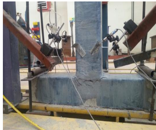
شکل ۱۲- نحوه‌ی ایجاد خرابی در نمونه‌های مقاوم‌سازی شده با CFRP
