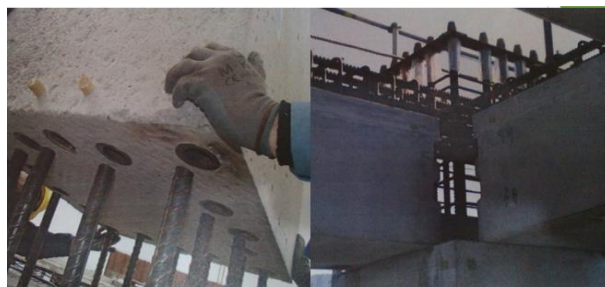
شکل ۱۲- وصله تزریقی در قطعات پیش ساخته ساختمان تجاری مسکونی سوپر فریم تبریز [۷]
