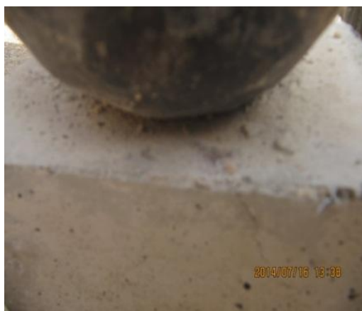
شکل ۳- پیدایش اولین ترک در بتن
